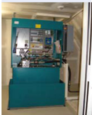
Das eigentliche Herzstück der Anlage: kompaktes Aggregat, im Dachgeschoss des Schlosses, mit abschließbarem Schaltschrank
